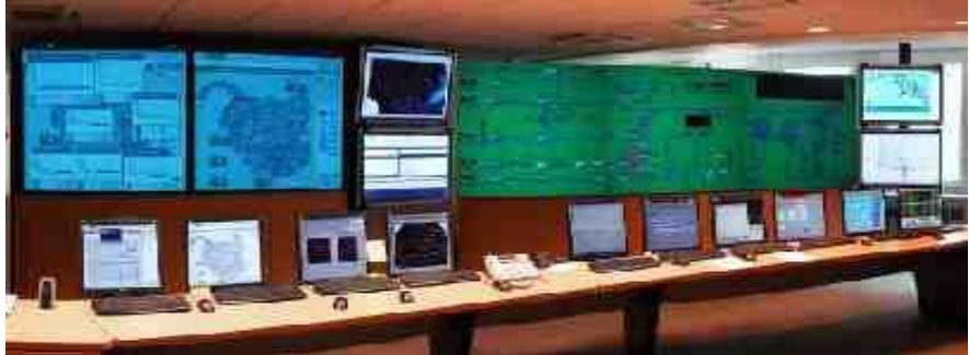
Control Room (SIAAP Paris)
